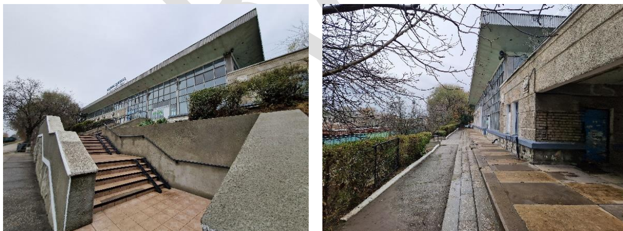
FIGURA 72. AUTOGARA UNGHENI – VEDERE DINSPRE STAȚIA CF. AMENAJARE DEFECTUOASĂ A FACILITĂȚILOR PENTRU PERSOANELE CU MOBILITATE LIMITATĂ
