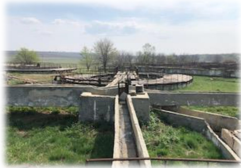
Figura 4. Stafia de epurare a apelor uzate: Decantor primar. Aductiune la decantor primar
